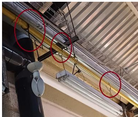
Imagen 4. Luminarias sujetadas a la tubería GLP. (Propia)
