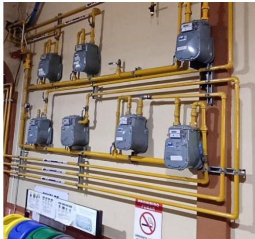
Imagen 9. Área de gasómetros sin protección. (Propia)
