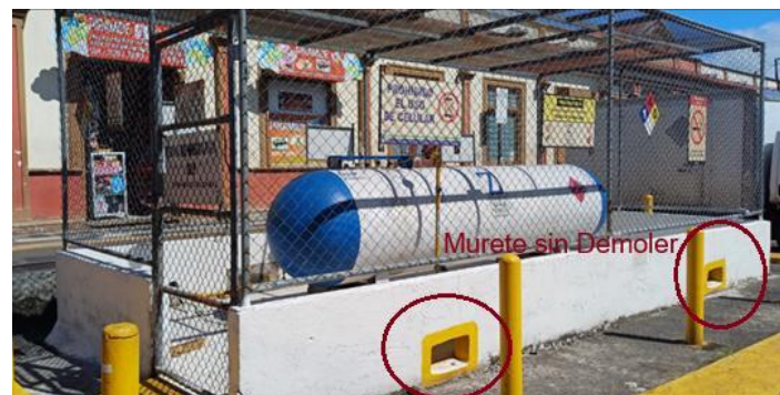
Imagen 3. Murete que muestra las perforaciones realizadas. (Propia)
