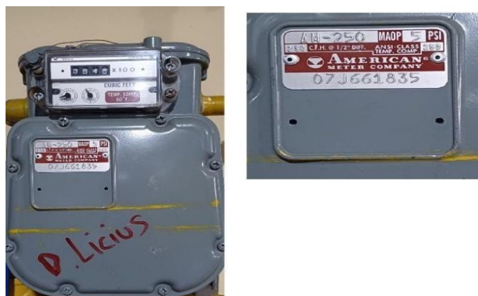
Imagen 5. Gasómetro sin sustituir. (Propia)
