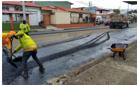
Imagen 8. Huellas de arrastre y regado de mezcla asfáltica.
