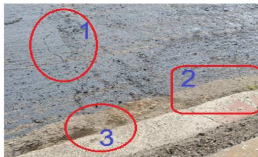
Imagen 9. Fisura sin resanar (1), zacate (2) y falta de riego vertical y horizontal (3)
