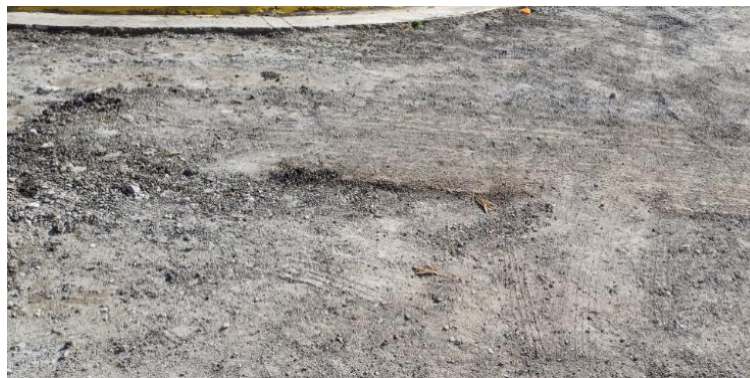
Imagen 5. La omisión del barrido, no se ajusta a buenas prácticas constructivas.
