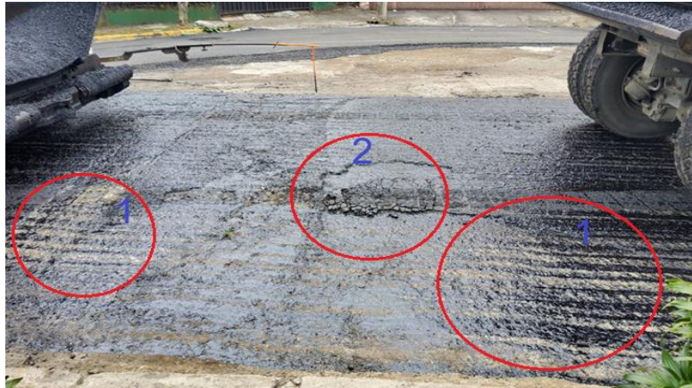
Imagen 6. Área con una cobertura no uniforme (1), material suelto (2)
