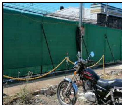
COSTADO SUR: (Colindancia con Avenida 2) No se han iniciado las obras
